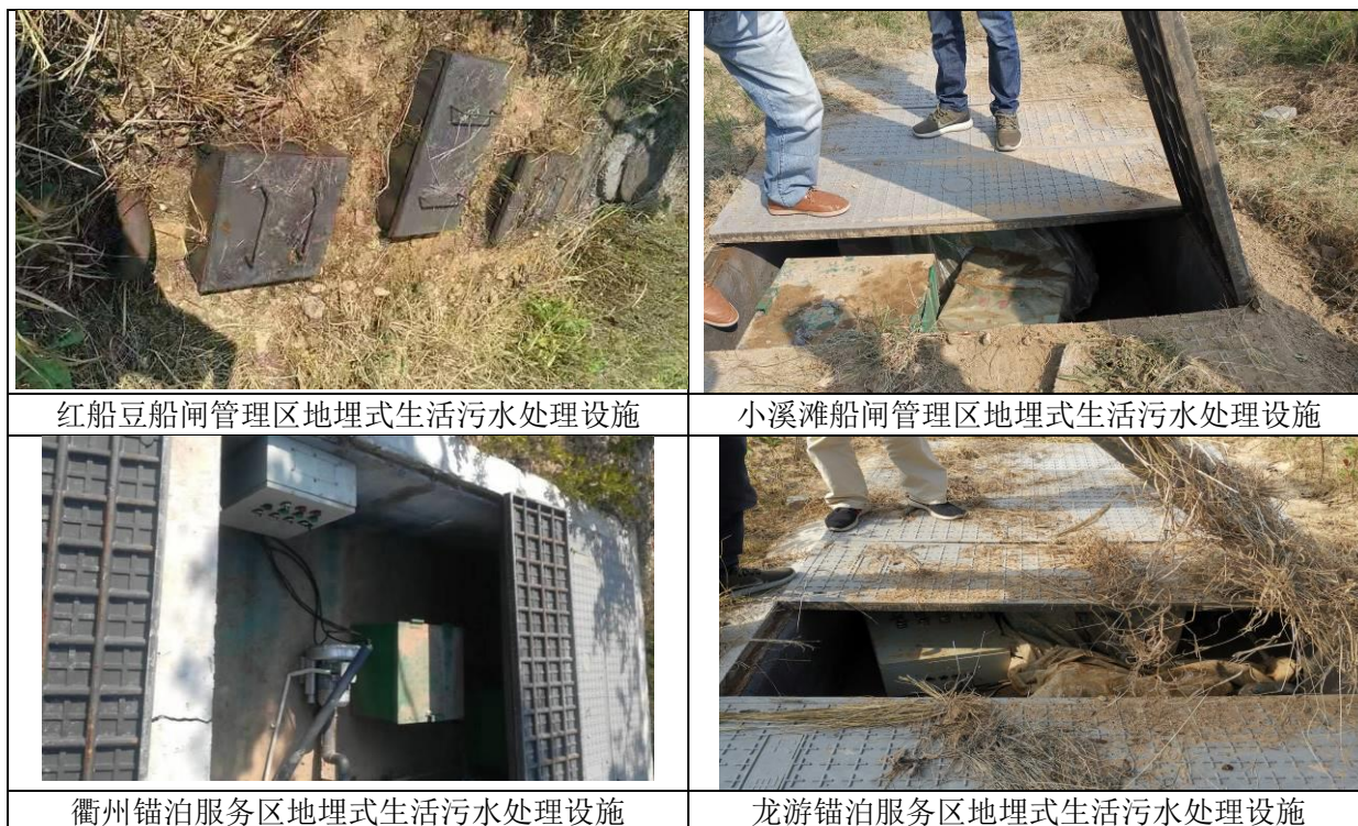
图 4.4-1 各船闸管理区及锚泊服务区地埋式生活污水处理设施
