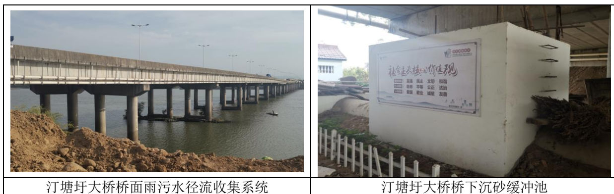
图 4.4-4 汀塘圩大桥改造工程桥面雨污水径流收集系统及沉砂缓冲池
