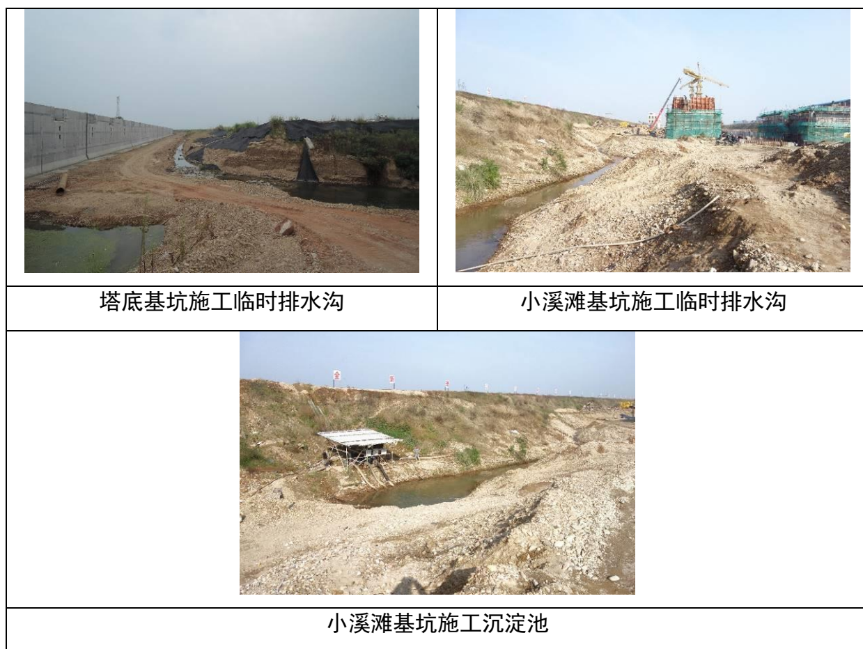
图 4.1-3 围堰基坑废水处理设施图
