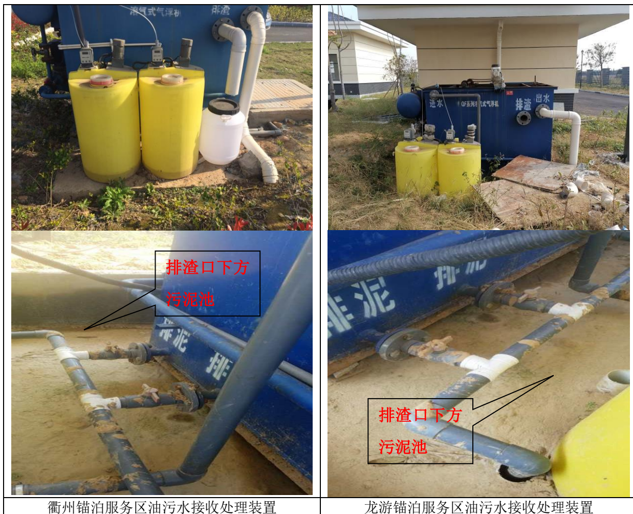
图 4.4-3 锚泊服务区已配备油污水接收处理装置
